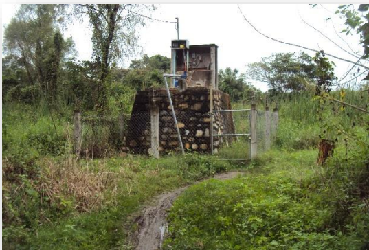
Foto 15. Bomba para la distribución de agua en el ejido.
